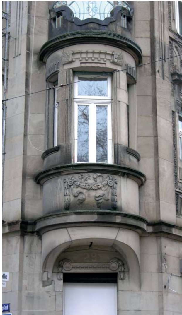
2006 – Wohnhaus, Rottmannstr. 48, Heidelberg Durchgeführte Arbeiten: Reinigung und Restaurierung der Außenfassade; Zustand vor (links) und nach (rechts) der Maßnahme.
